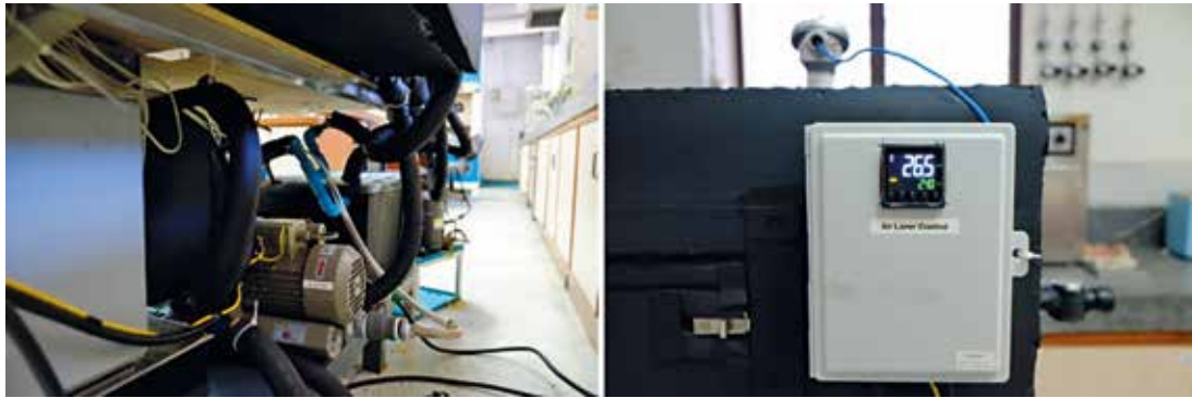
รูปที่ 9 ชุดปั๊มดูดอากาศจากภายนอกก่อนเข้าสู่ระบบปรับอุณหภูมิของอากาศก่อนจ่ายให้กล่องปิดและระบบควบคุมการทำงานของปั๊มอัตโนมัติของกล่องปิดรอบตู้ทดสอบ
