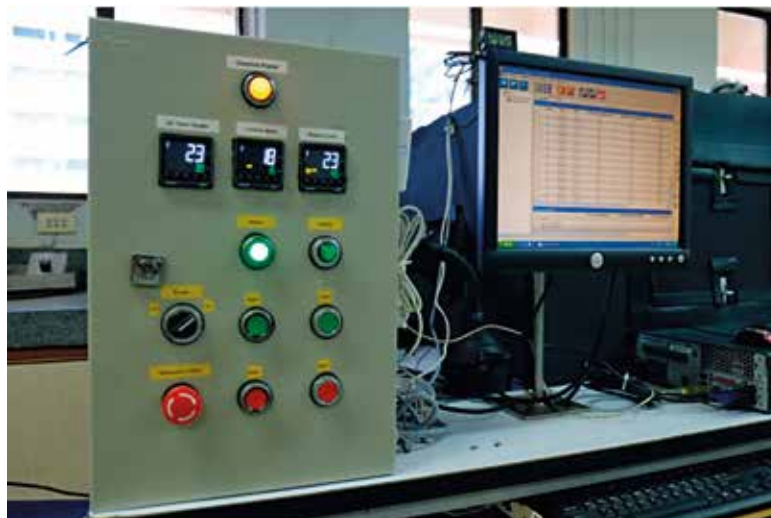
รูปที่ 6 ชุดแผงควบคุม (Control Panel) อุณหภูมิของน้ำเย็นในระบบทำน้ำเย็น
